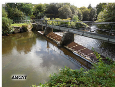
ANCIENNES GRILLES DE GUIDAGE ABAISSEES EN SEPTEMBRE 2016
