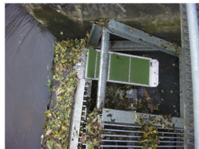
RAMPE A ANGUILLES DEPUIS FIN SEPTEMBRE 2019 (Y. ABALAIN)
